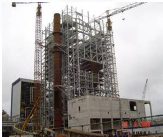
Caldeira de Recuperação
