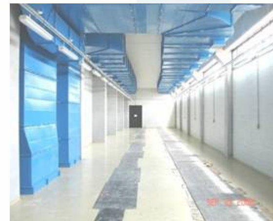
Turbogerador - Sala Elétrica
